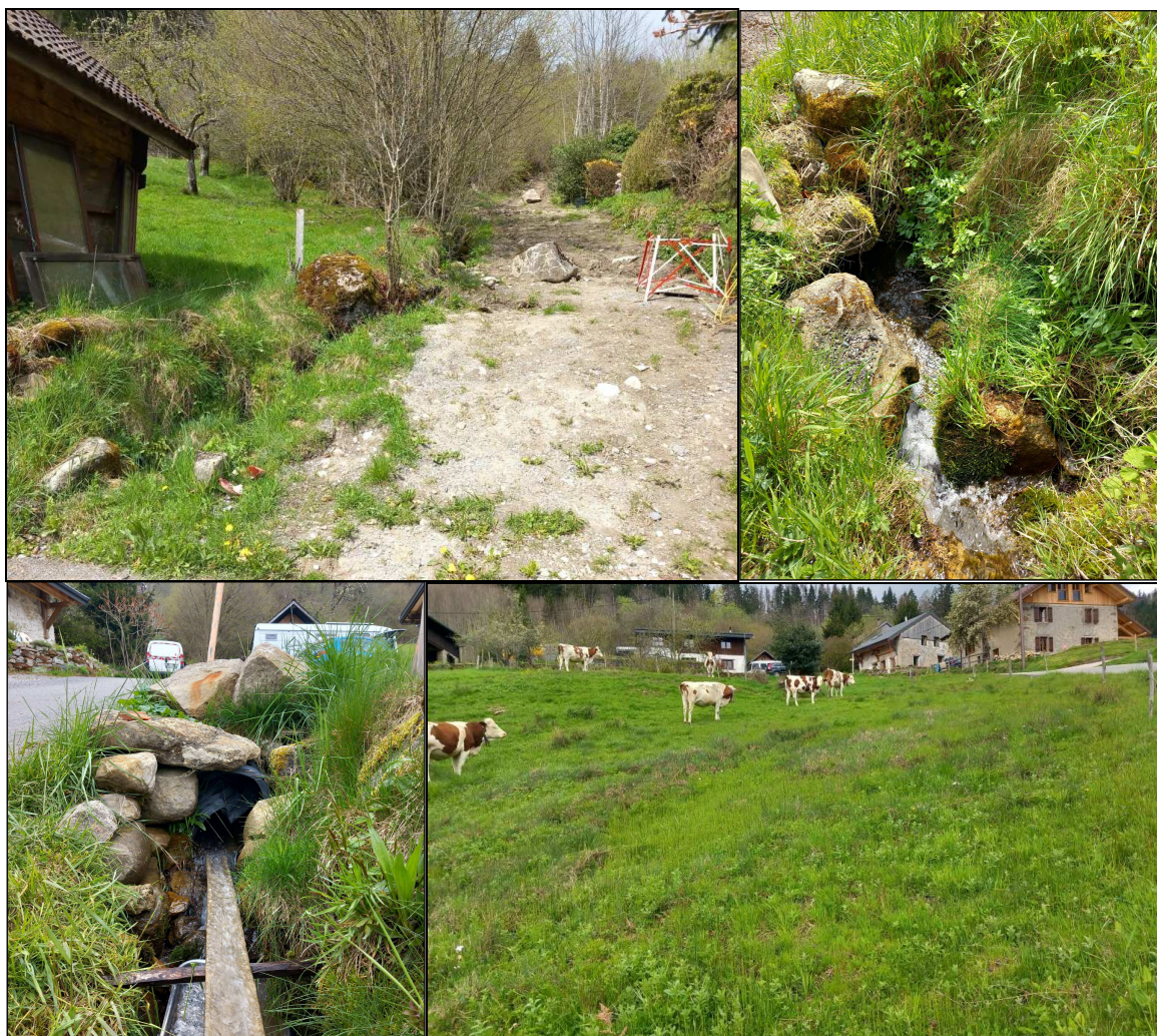
De gauche à droite et haut en bas : ruisseau et chemin à l'amont du hameau ; obstruction de l'entonnement du busage ; écrasement du Ø400 PE ; humidité récurrente de la pâture
