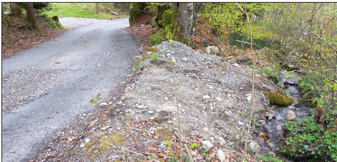
Dépôt sur les berges du ruisseau
