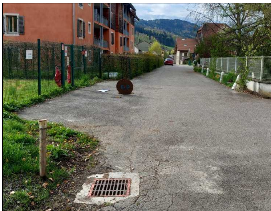
Réseau d'eaux pluviales, chemin des Grands Prés
