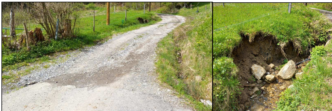
Risque de ravinement d'un chemin – Erosion des berges d'un fossé
